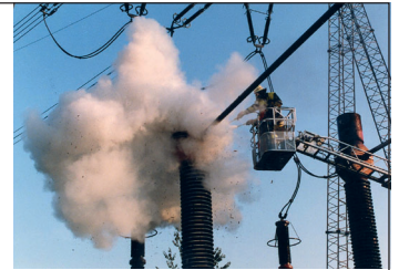
Bild 3: Hochspannungsanlagen (über 1000 V)
